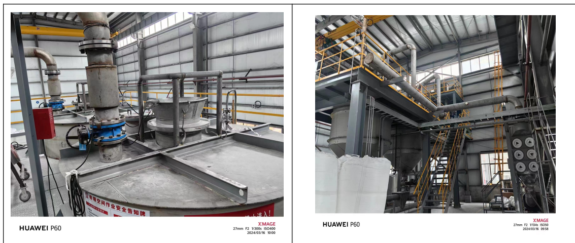
图 3.3-1 现有投料粉尘收集措施现场照片
