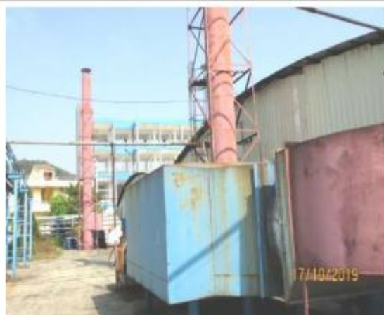
洗桶车间废气处理设施（活性炭吸附装置）
