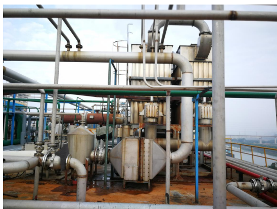
环氧树脂废气处理设施（活性炭装置）
