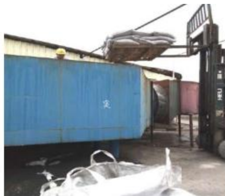
洗桶车间废气处理设施（活性炭吸附装置）
