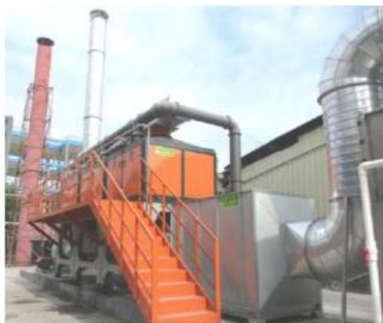
洗桶车间废气处理设施（气旋喷淋塔+干式过滤+活性炭吸附+脱附催化燃烧装置）
