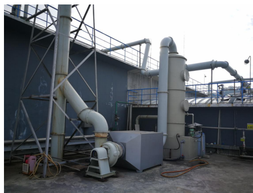
污水处理站废气处理设施
