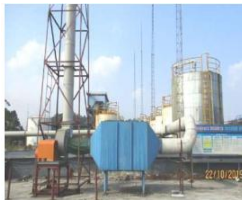
罐区废气处理设施（活性炭吸附装置）
