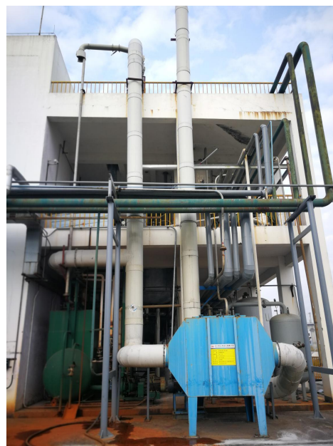
丙烯酸树脂车间废气处理设施（活性炭装置）
