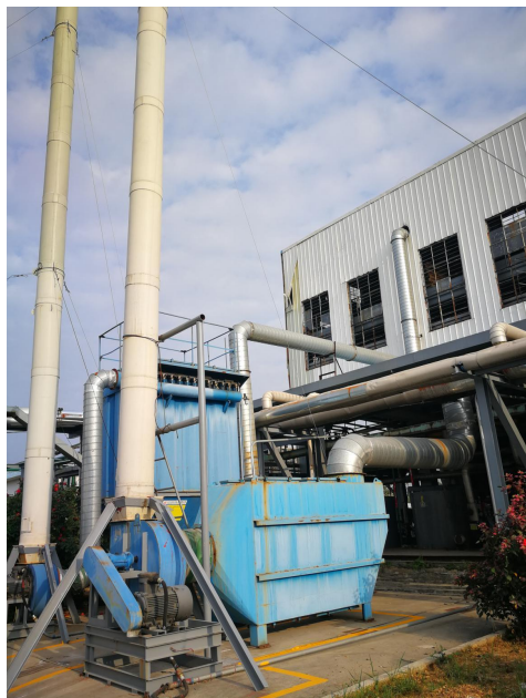
醇酸树脂废气处理设施（布袋除尘器；活性炭装置）
