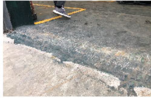
(b) 危废仓门口漫坡
