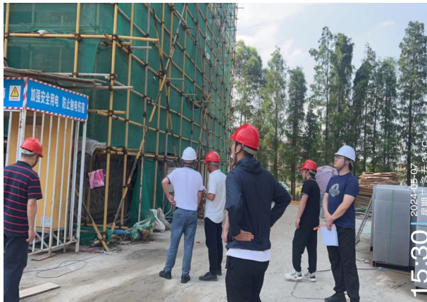
开平市住房和城乡建设局检查“雅涛居-1#住宅、2#住宅、3#住宅、5#住宅、6#住宅、地下车库”
