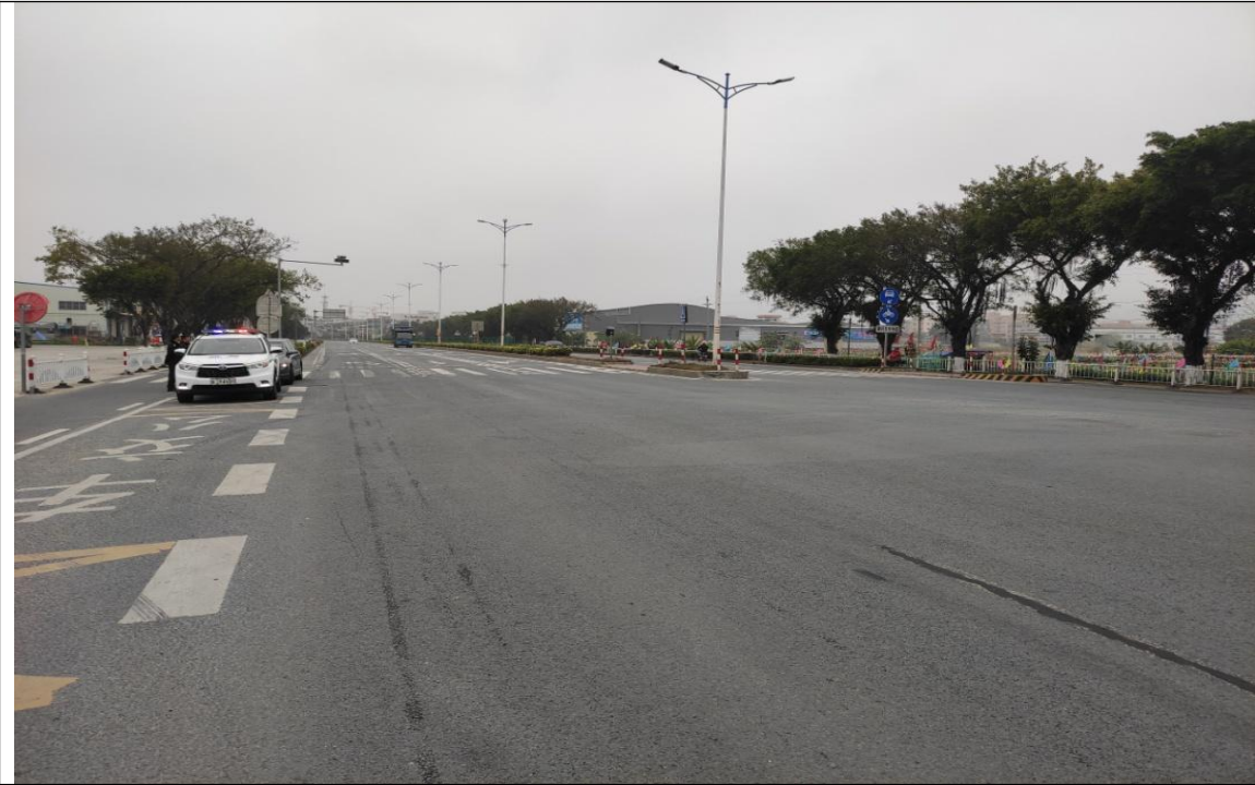
位置: 恒量检测站路口 情况: 该路段两侧为工业区, 村落较多, 掉头车辆及横过公路人群较大。 桩号: K109+250 优化后: 将该处改造成灯控路口, 人行横道安全岛降低与路面持平。
