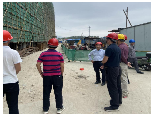
蓬江区住房和城乡建设局检查 “蓬江区高端装备制造产业园 基础设施配套工程”
