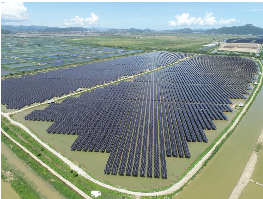
图 2.3.3-1a 光伏现场照片图
