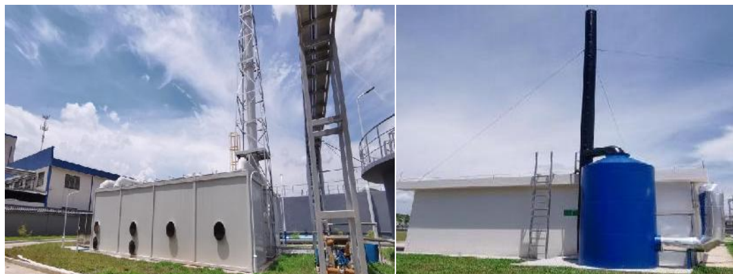
图 3.4-1 左-生物除臭装置 右-备用发电机废气治理设施
