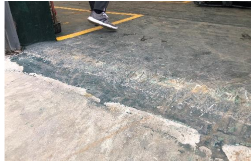
(b) 危废仓门口漫坡
