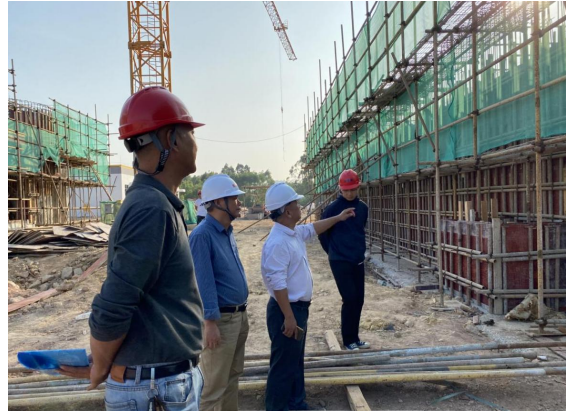
开平市住房和城乡建设局检查“开平市城区楼冈及月山、水口、苍城、大沙四个镇级污水处理设施 PPP 项目-月山镇生活污水处理厂（一期）”
