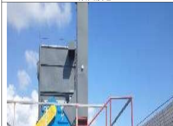
定型废气处理设施
