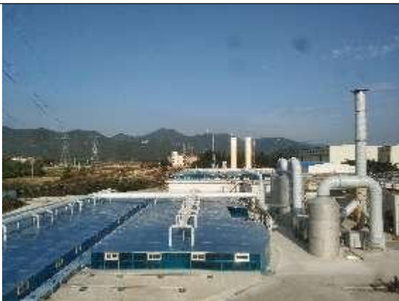
废水站废气处理设施
