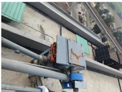
图 13 1#炉前煤仓粉尘环保处理设施: 袋式除尘器
