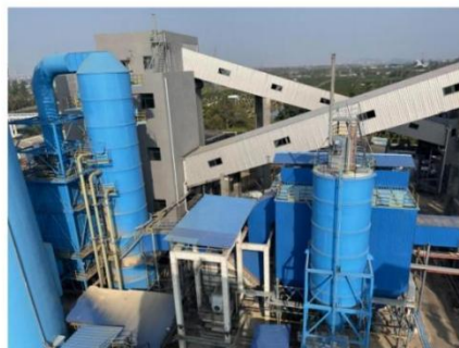
图 20 锅炉烟气环保处理设施: SNCR+SCR 脱硝+袋式除尘器+石灰石、石膏湿法脱硫+湿式电除尘器
