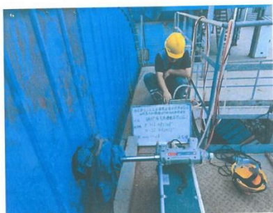
锅炉废气处理前采样口G1采样
