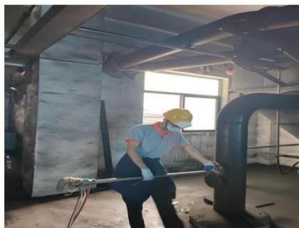
图 8 燃煤破碎出口粉尘的 6#除尘器(处理前)
