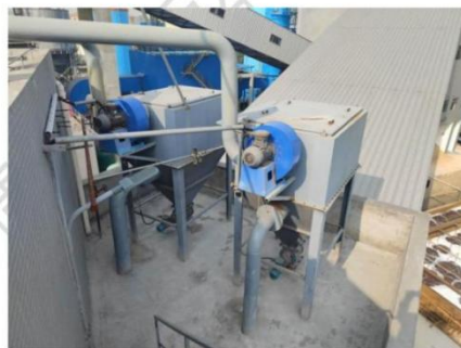
图 4 1#输煤转运站粉尘环保处理设施: 袋式除尘器
