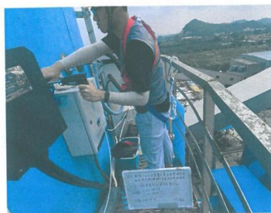
锅炉废气处理后采样口G2
