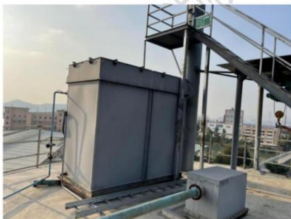
图 17 灰库环保处理设施: 脉冲除尘
