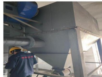
图 6 2#输煤转运站粉尘环保处理设施: 袋式除尘器
