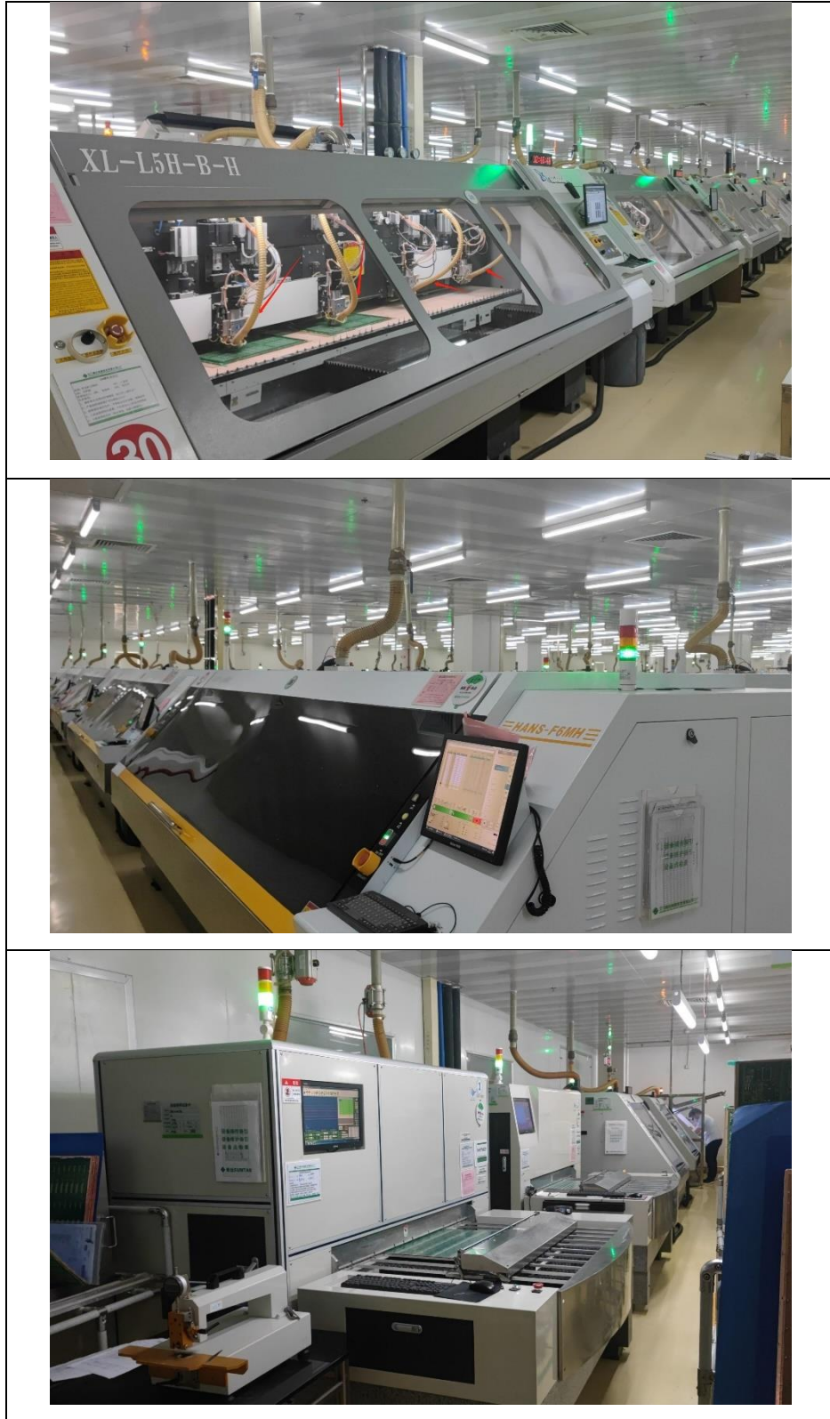
图 1.1.4-5 现有项目钻孔机、V-CUT 机、锣机等集尘措施实拍图
