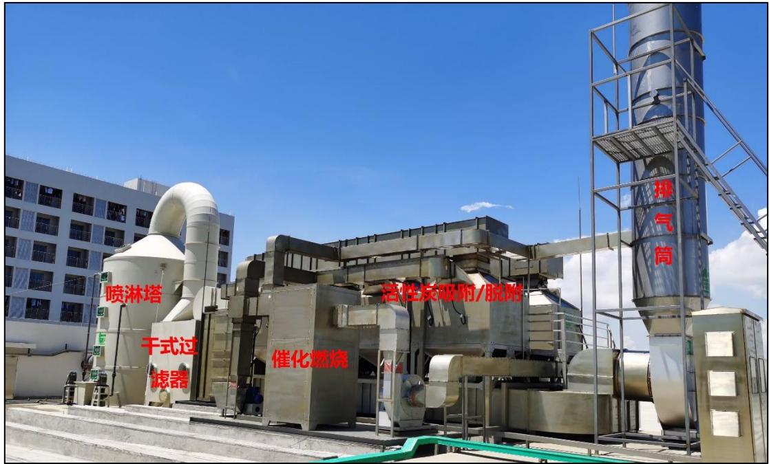
图 1.2.7-6 珠海崇达公司有机废气处理措施实拍图
