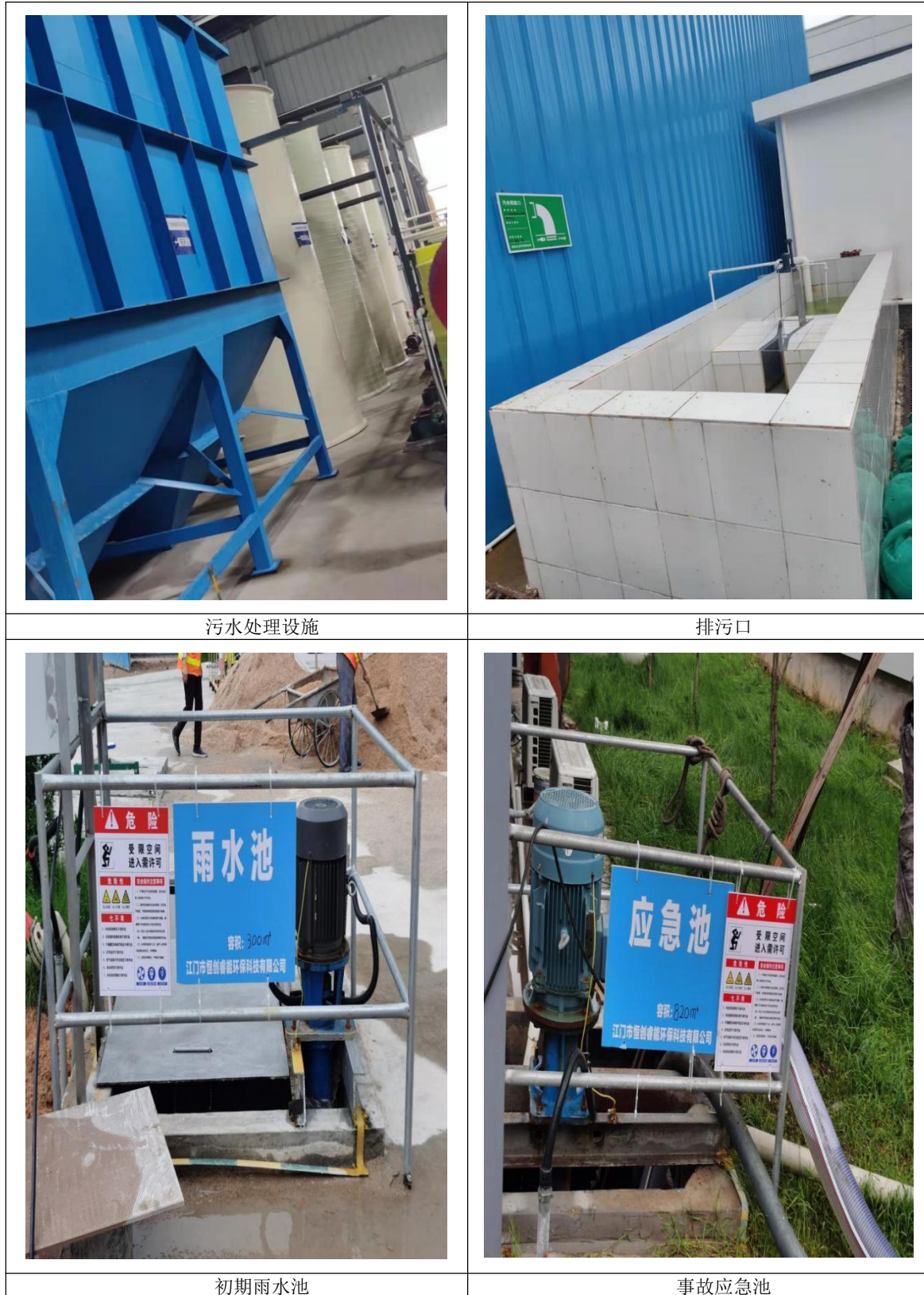
图 3.4-7 现有项目水处理设施图片
