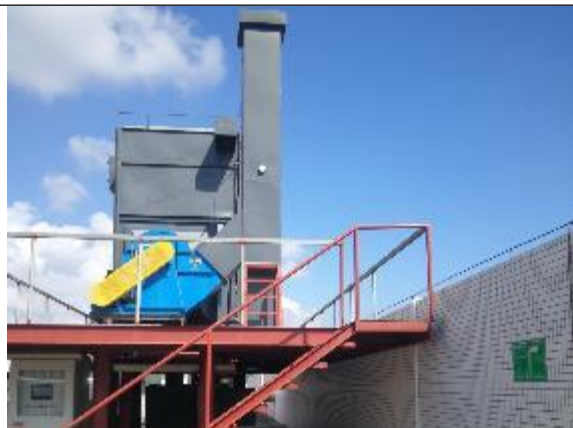
定型废气处理设施
