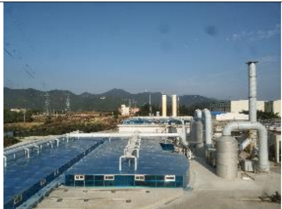
废水站废气处理设施
