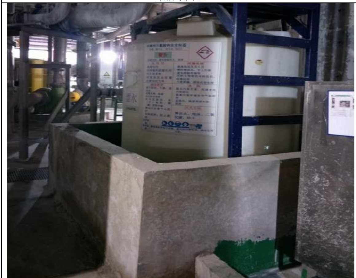
次氯酸钠罐围堰
