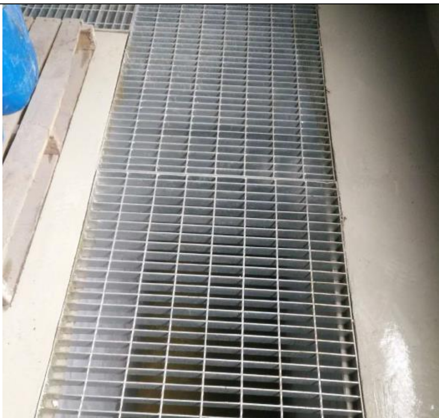
危废仓废液事故应急池
