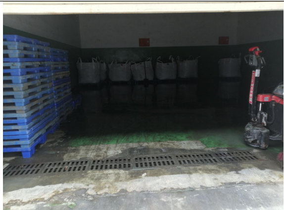
危险废物仓库内部防渗和导流
