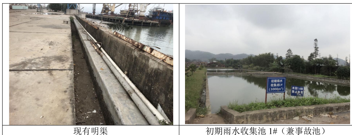
图 3.4.4-2 本项目初期雨水收集池
