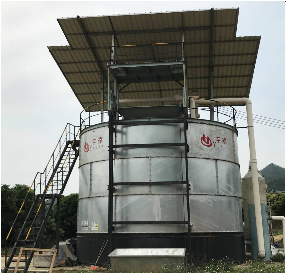
图 7.5-3 项目发酵罐实物图
