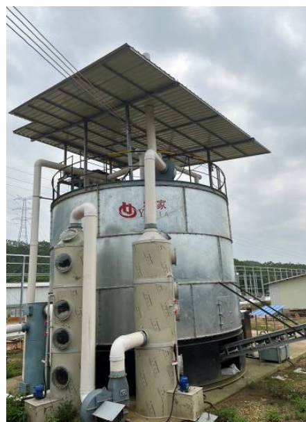
发酵罐及配套除臭设施
