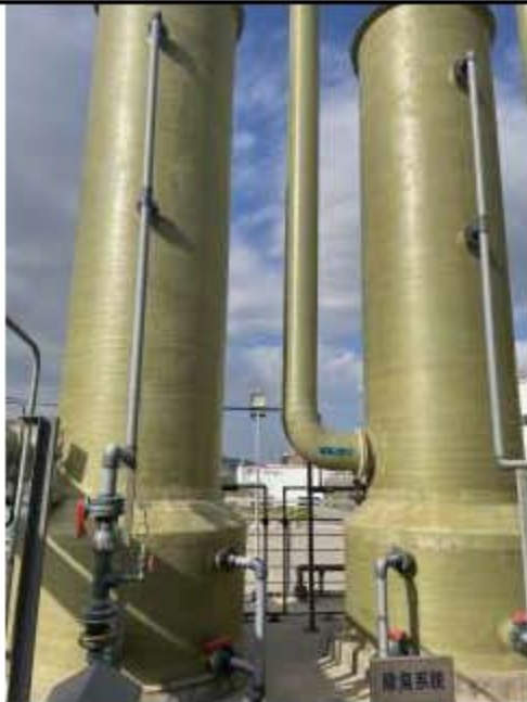
污水站恶臭处理系统
