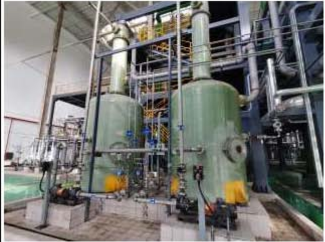
磺化废气处理设施
