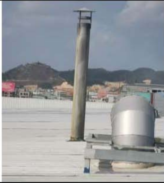
磺化废气排放口
