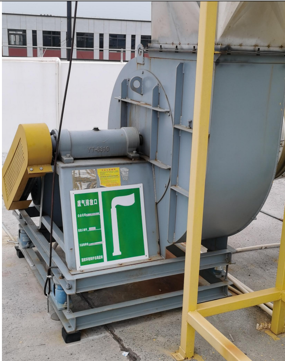
主厂房——排气筒（DA003）标志牌
