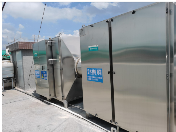
树脂生产线-治理设施 (UV+活性炭)
