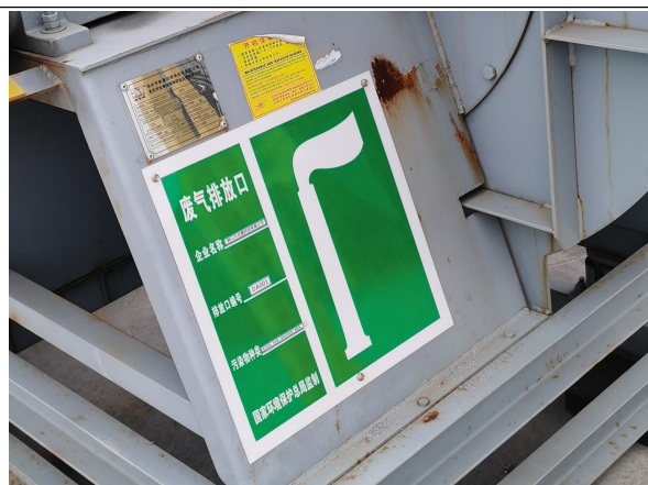
树脂生产线—排气筒 (DA001) 近景
