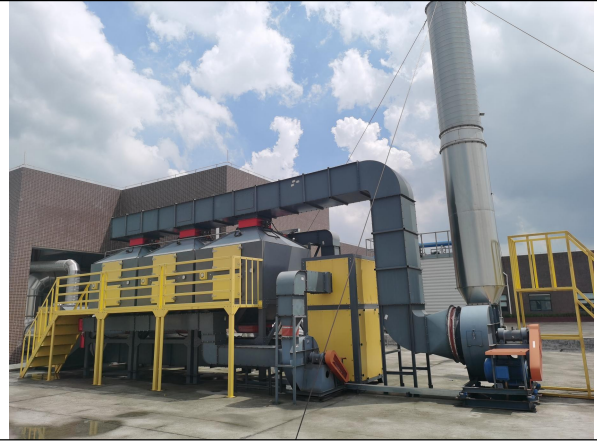
主厂房—治理设施（预过滤器+活性炭+催化燃烧装置）
