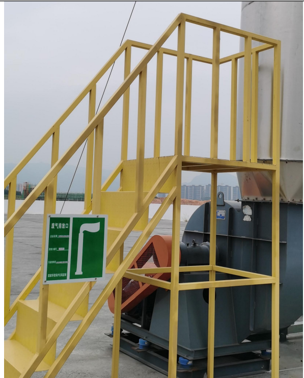
主厂房——排气筒（DA002）标志牌
