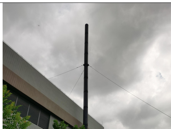
公用工程—蒸汽锅炉排气筒 (DA004)
