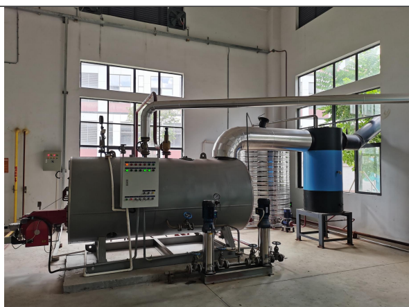
公用工程—锅炉房 (蒸汽锅炉)
