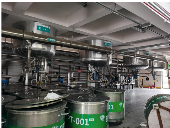
树脂生产线-反应釜底部卸料口
