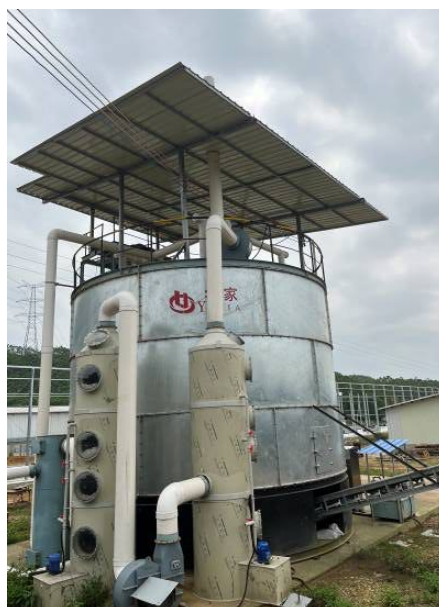
发酵罐及配套除臭设施
