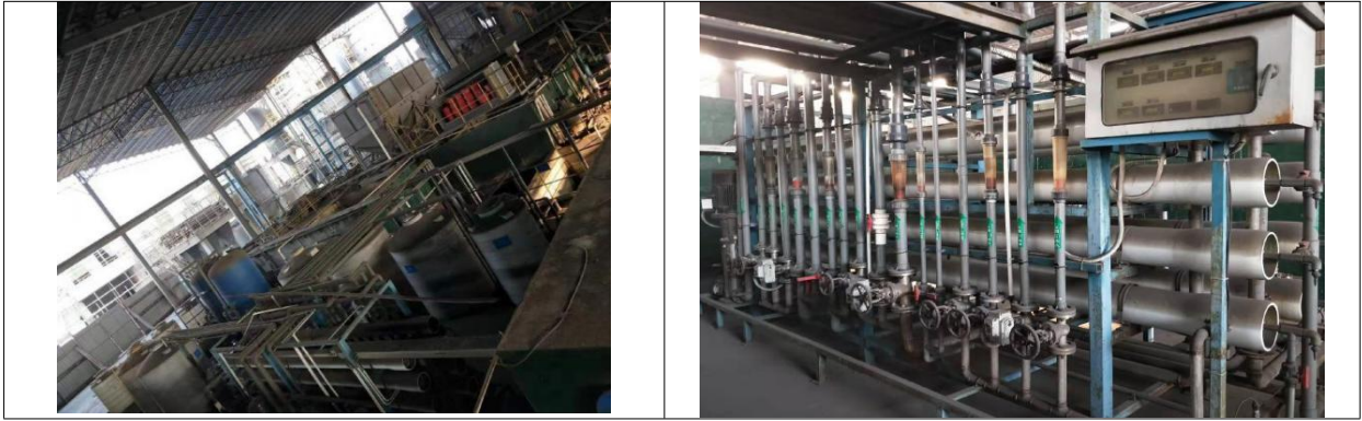
图 9.5-2 现有项目废水治理措施照片
