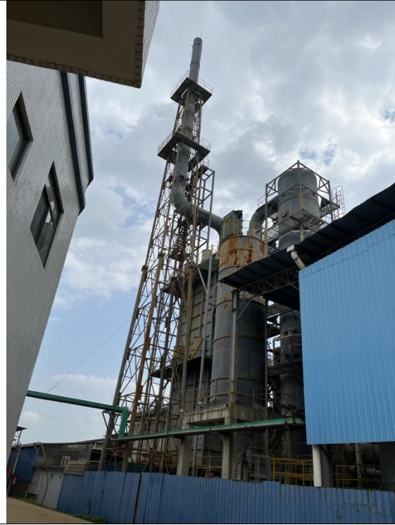
废气处理措施及排气筒
