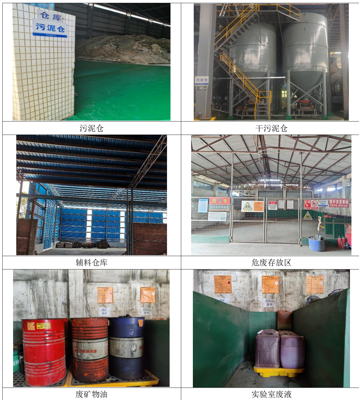
图 9.5-1 现有项目仓库和生产区防渗漏措施照片
