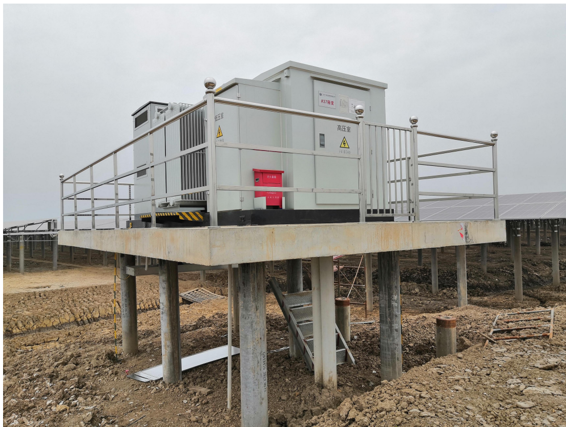
图 2.1.3-3 项目建设现状（箱逆变）
