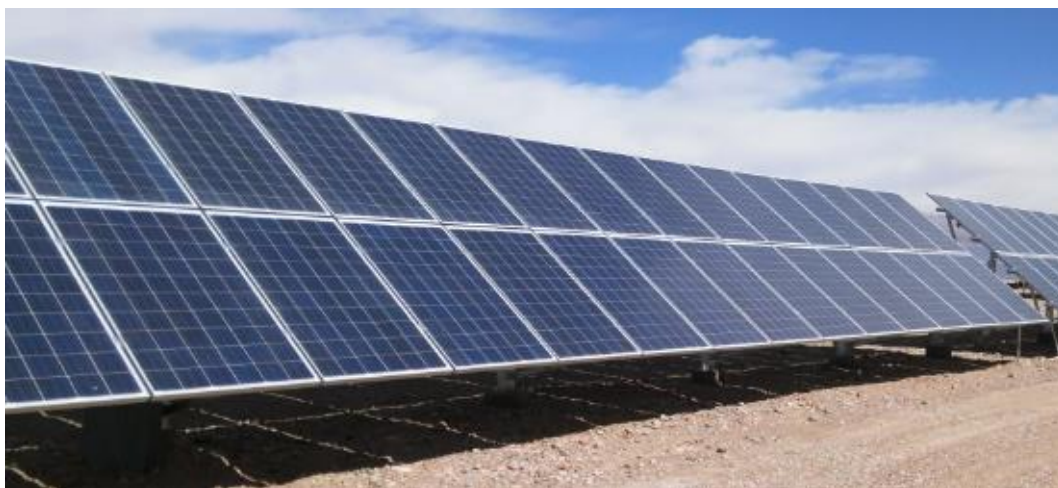
图 7.4.1-1 光伏组件竖向布置 2×竖向排布实景图
