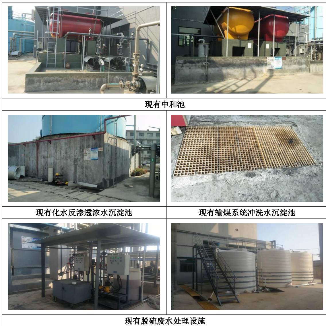
图 3.9-3 现有废水治理设施照片
