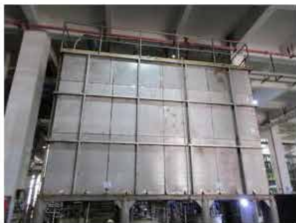
硫酸镍项目废水处理站
