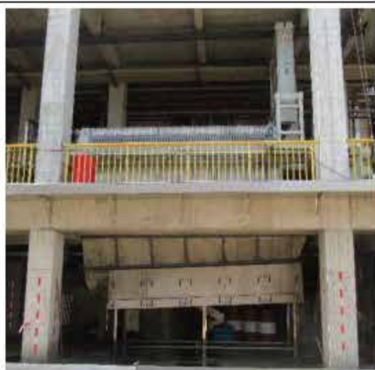
含氨废水处理站：压滤机
