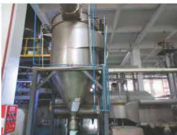
含尘废气治理设施（布袋+旋风除尘）
