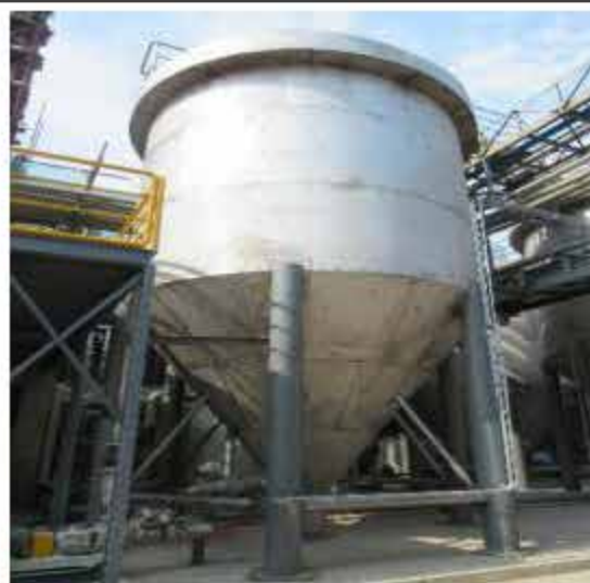
含氨废水处理站：沉降池
