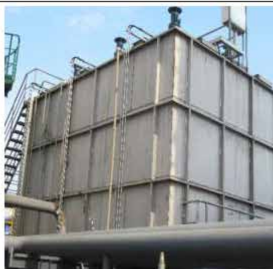
含氨废水处理站：pH 调节装置
