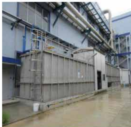
淋浴水回用处理站
