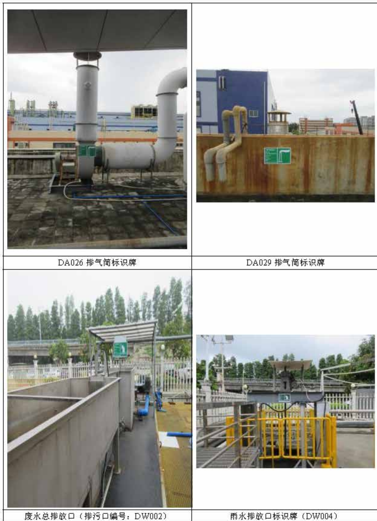
图 4-24 现有工程排放口标识牌设置现场照片
