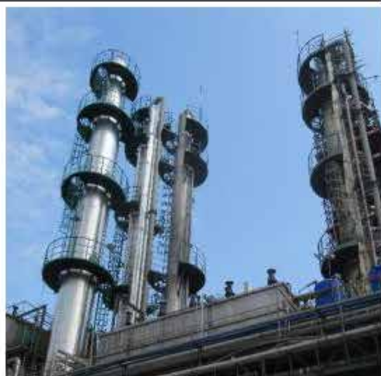
含氨废水处理站：脱氨塔
