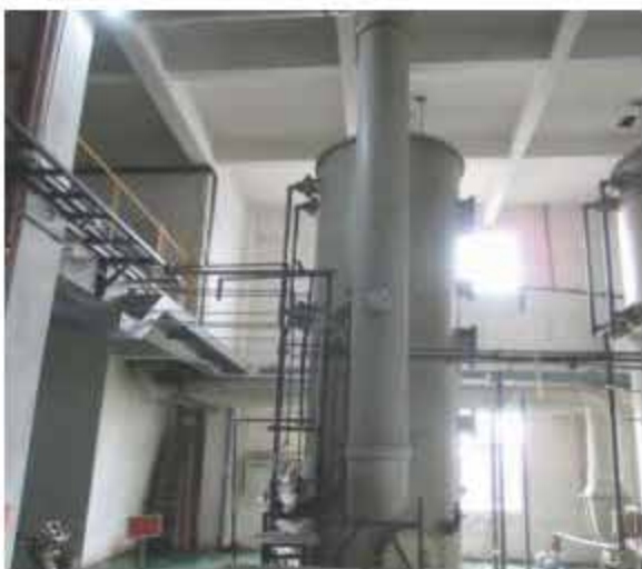
酸性废气处理设施（碱喷淋吸收塔）
