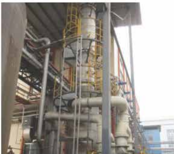
含氨废气处理设施（吸氨塔）
