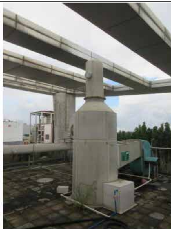
DA023 排气筒标识牌
