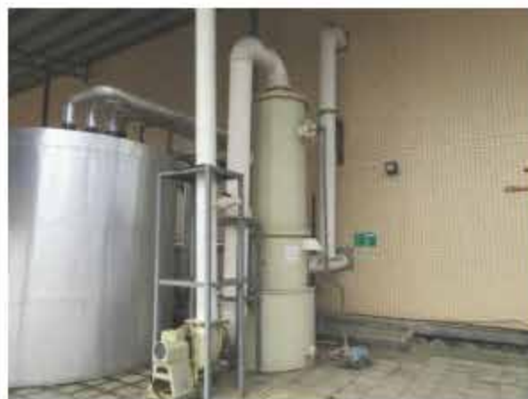
萃取有机废气处理设施（水喷淋吸收塔+回收装置）
