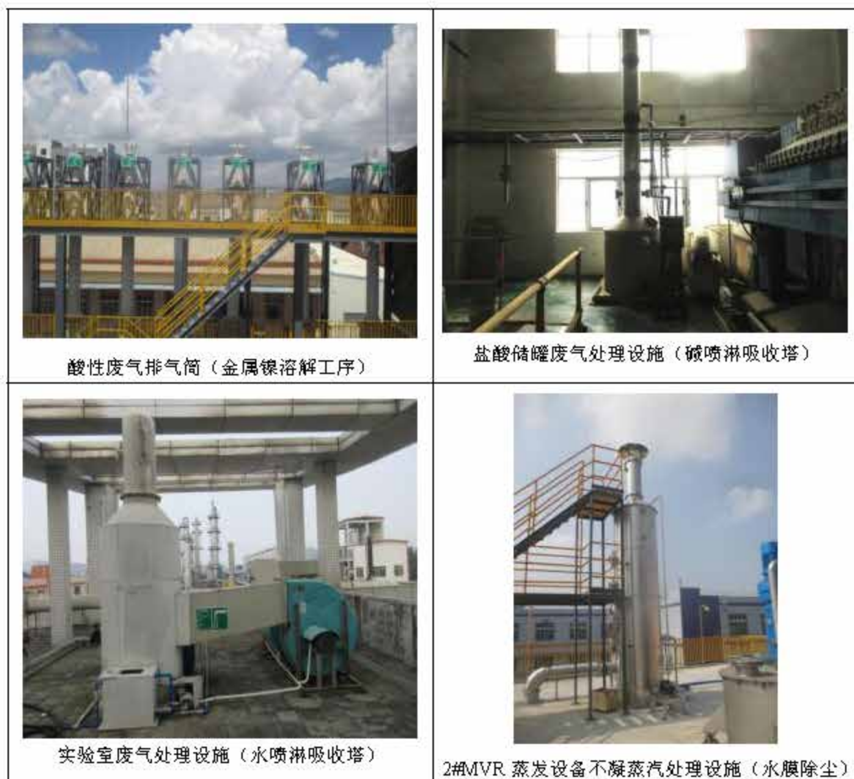
图 4-19 现有工程废气治理设施现场照片
