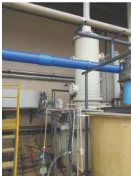
蒸发结晶酸性废气处理设施（水喷淋吸收塔）
