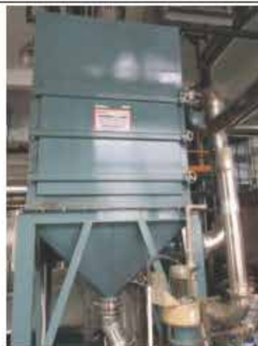
含尘废气治理设施（烧结板除尘器）
