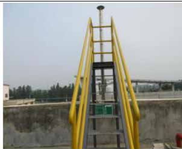
DA027 排气筒采样平台及标识牌
