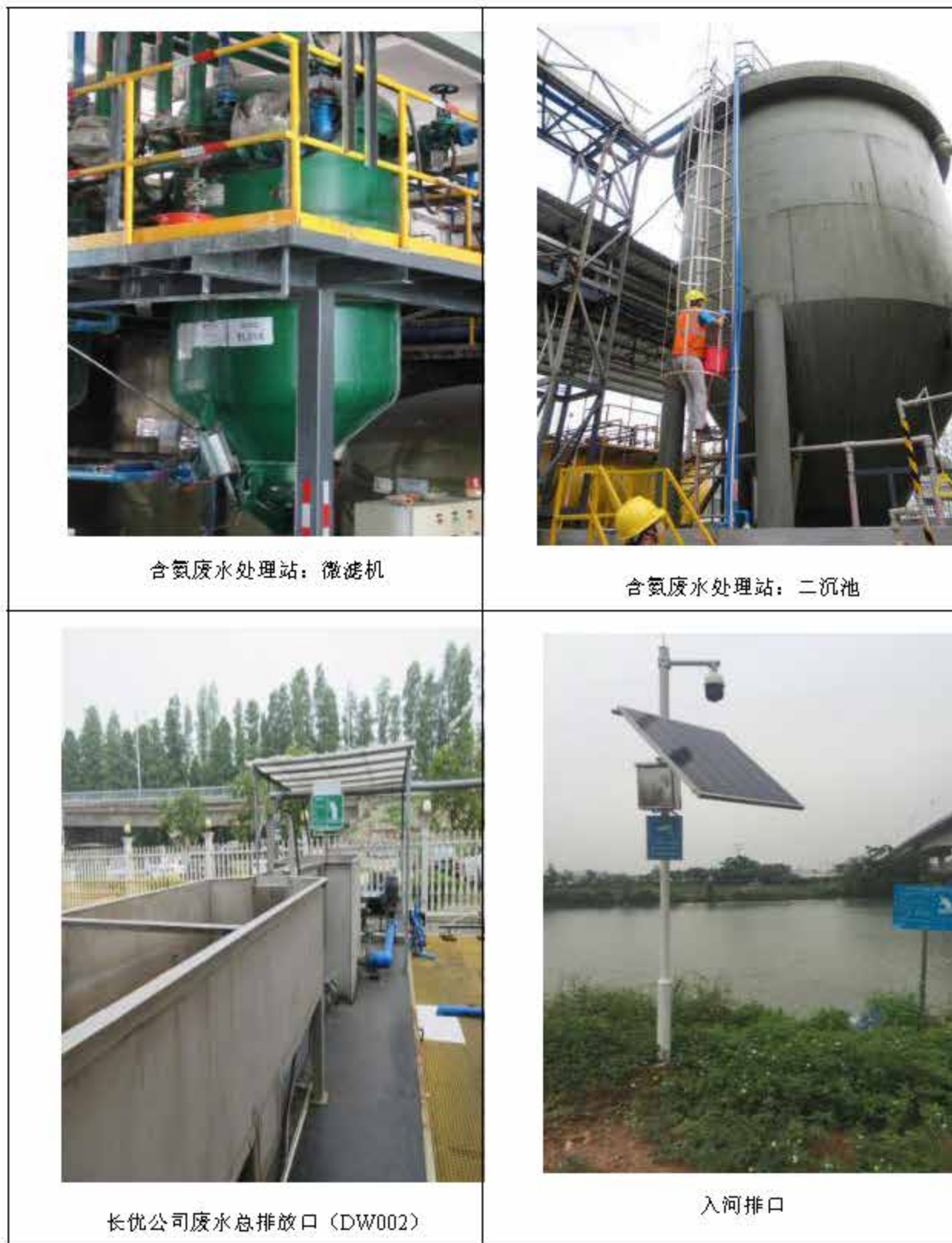
图 4-17 现有工程废水处理站现场照片
