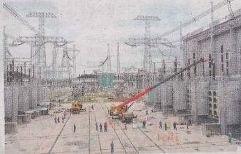
雅中特高压邵阳换流站流变场竣工。 工厂川摄
