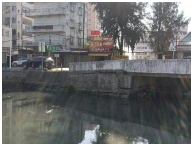
3#桥台挡墙下沉开裂
