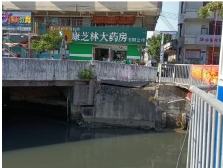
0#桥台挡墙下沉开裂
