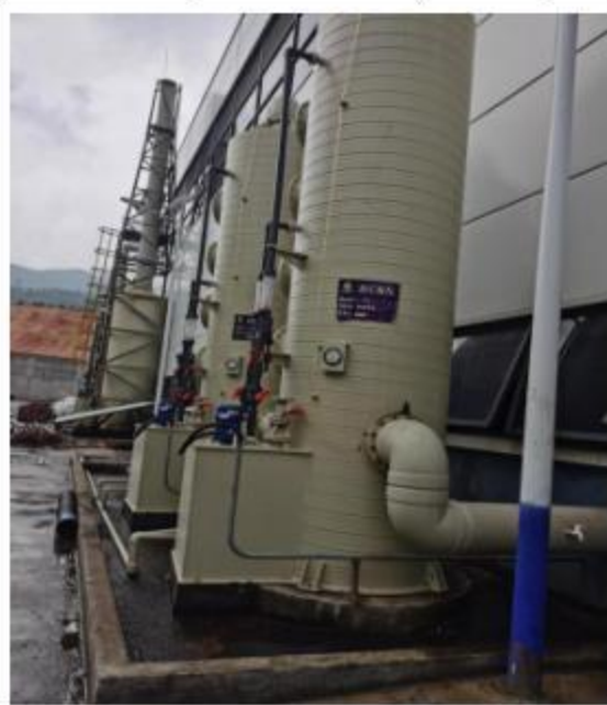
二级碱液喷淋塔
