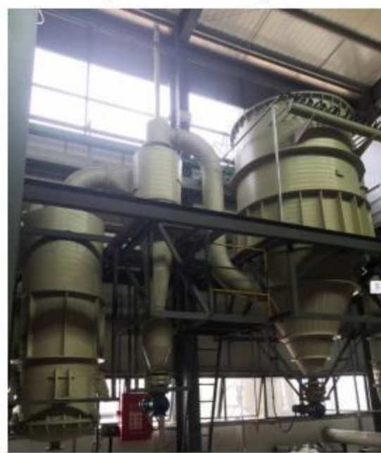
布袋除尘器+旋风除尘器
