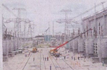
南昌特高压新洲湖换流站换流变广场。 原川摄
