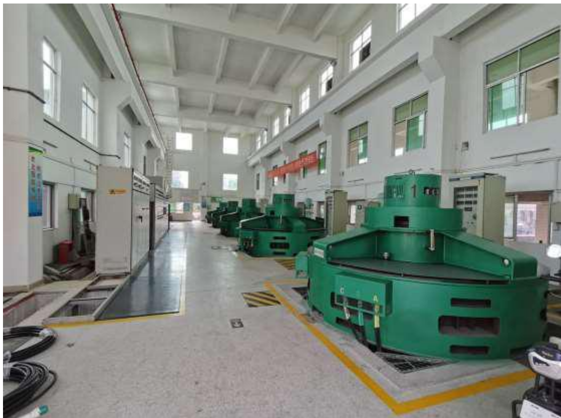
图 4.2.1-4 厂内发电机层全貌
