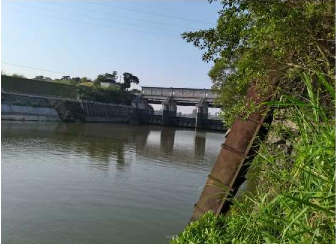
图 4.2.1-5 生态流量泄放设备设施（东闸）
