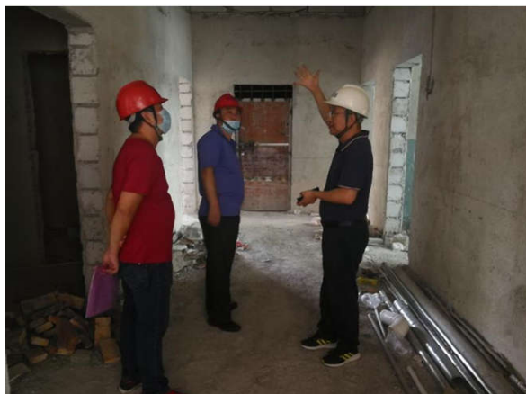
开平市住建局检查“开平市中心医院妇产儿科住院大楼”项目
