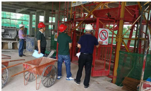
开平市住建局检查开平市苍江中学教学楼及配套设施工程
