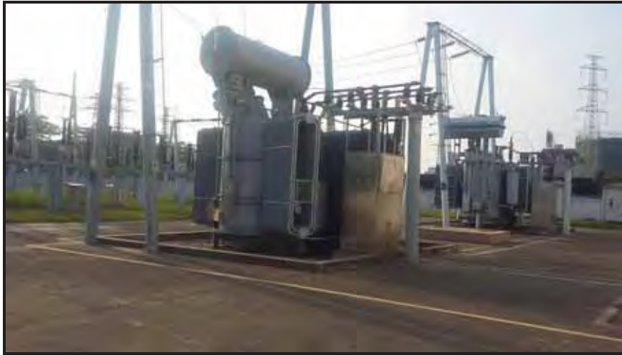
图 2 110kV 振华站现有#1、#2 主变
