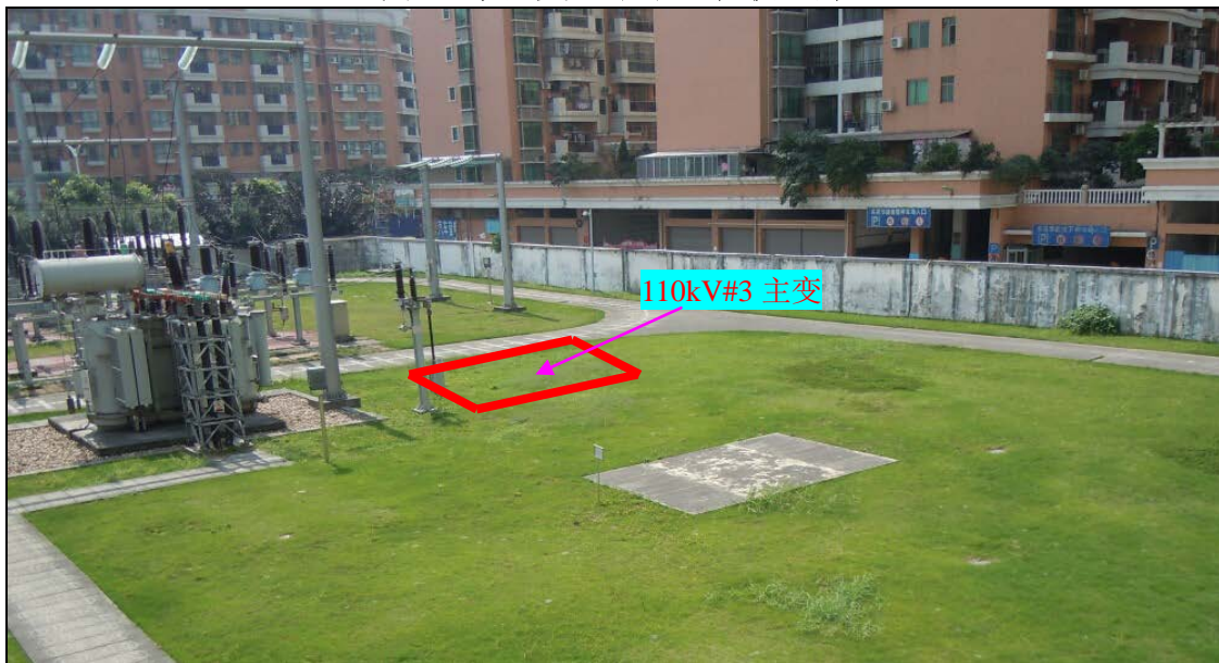
图4 扩建#3主变位置
