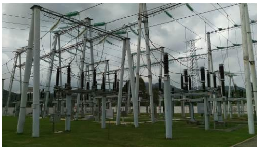
110kV 出线构架
